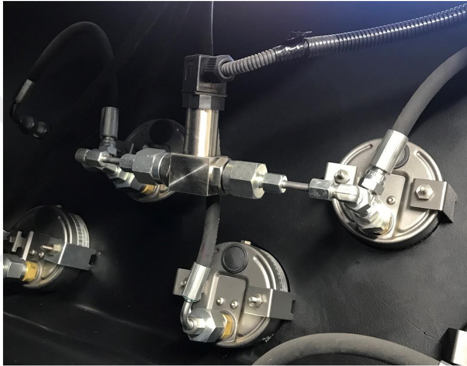
Şekil 3.8. Fark basıncı sensörü ve filtre giriş çıkış hatlarına bağlanan manometreler
